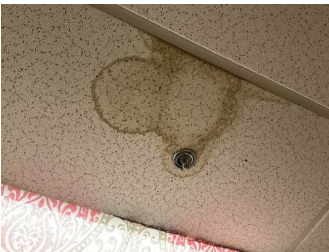
71 - FIRE SUPPRESSION PHOTO
