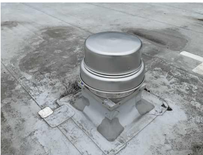
41 - ROOF TOP EXHAUST FAN
